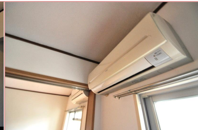
エアコン付き(2基)!
