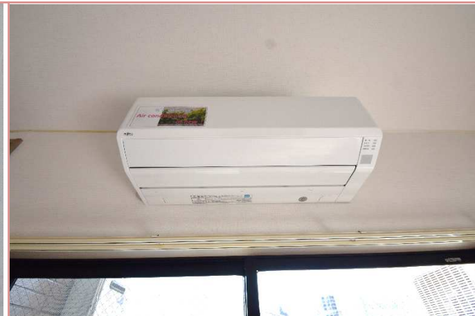
エアコン ハイパワーなエアコンに交換済み！(2.8kw)
