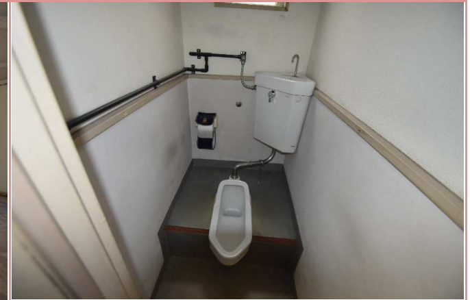
共用スペース内トイレ 和式水栓
