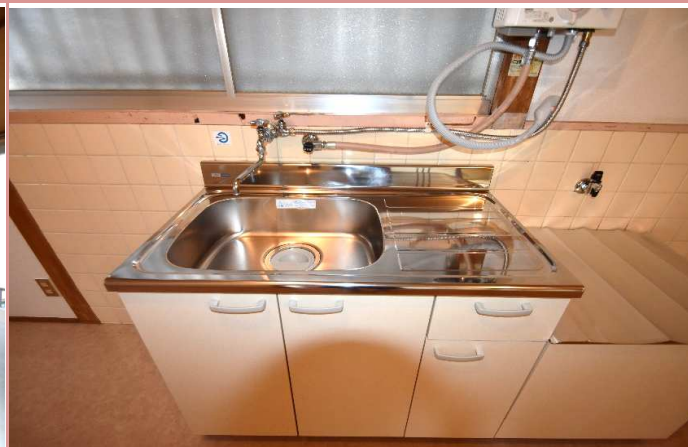
キッチン 新品です。瞬間湯沸かし器も交換済み！
